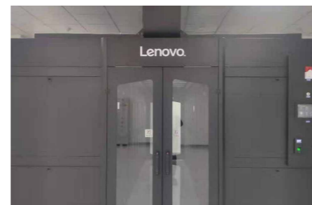
数据中心模块化机房
